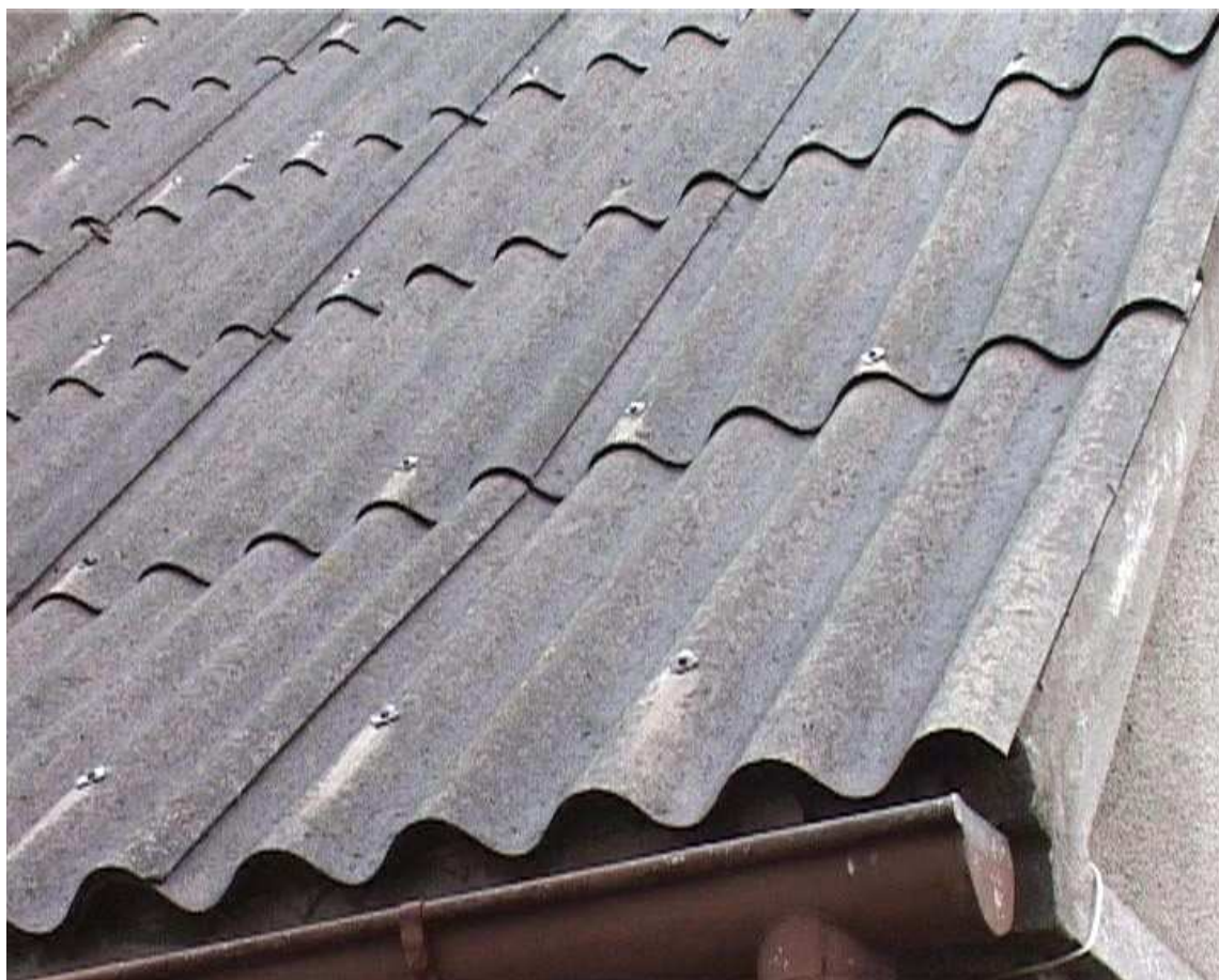
Rys.7. Płyta azbestowo-cementowa falista tak zwany eternit [ 11]
