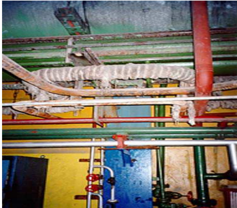
Rys.8. Izolacja rurociągów ze sznurów azbestowych w elektrociepłowni [ 5]
