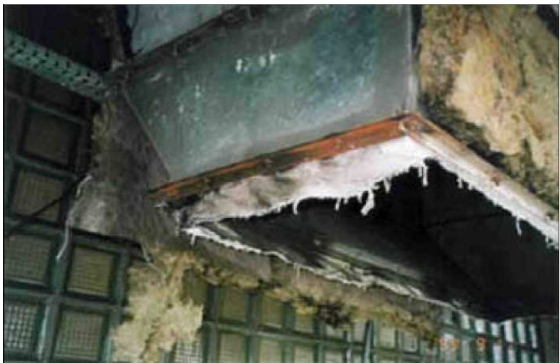
Rys.9. Płótno azbestowe w przewodach wentylacyjnych [ 5]
